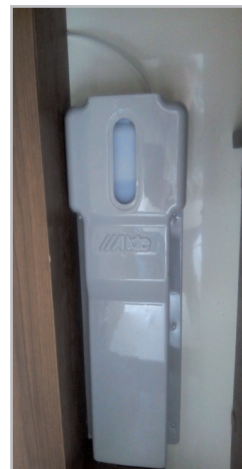
Fig.6.48 - Niveau du mélange de glycol
