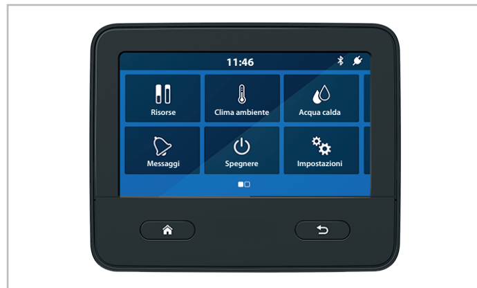
Fig. 6.49 - Panneau de commande
