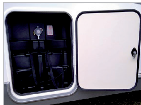
Εικ. 6.30 - Χώρος φιαλών αερίου
