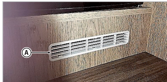
Fig. 6.1 - Aperture permanenti di ventilazione
